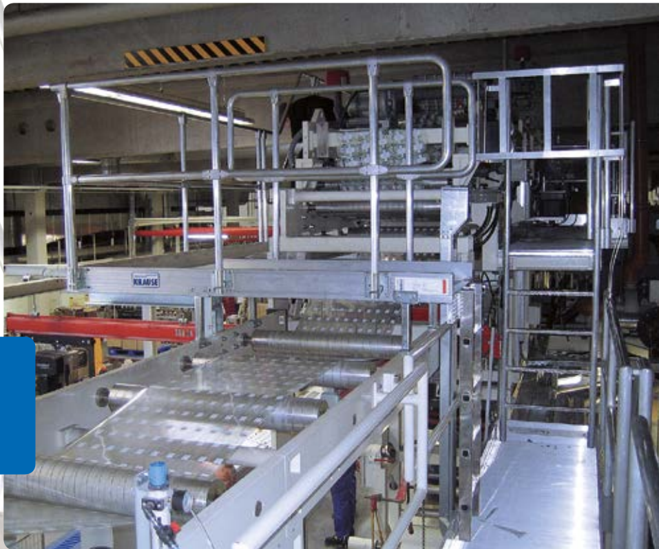
Platforma konserwacyjna z wkładanymi barierkami, wejście za pomocą drabiny ze szczelami
